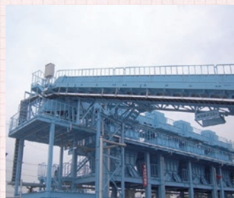
▲下水処理場内に設置されたベルトコンベアです。
